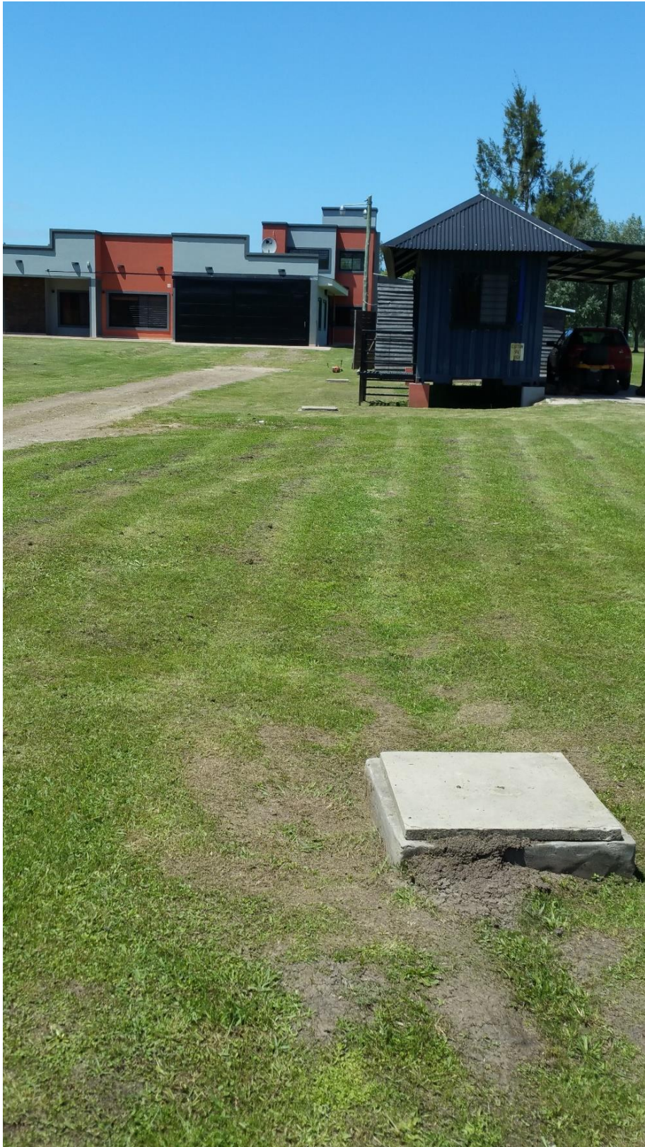
Camaras de inspección eléctrica cada 25 mts aproximadamente.
