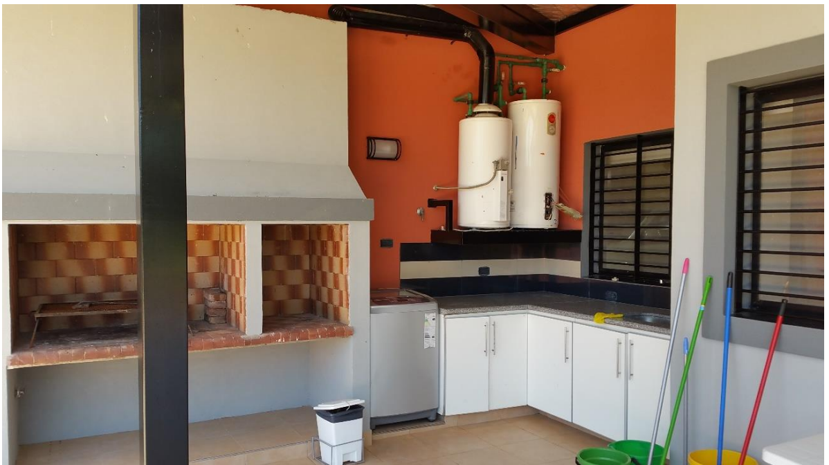
Doble Termotanque, eléctrico y a gas. Ambos de alta recuperación.
