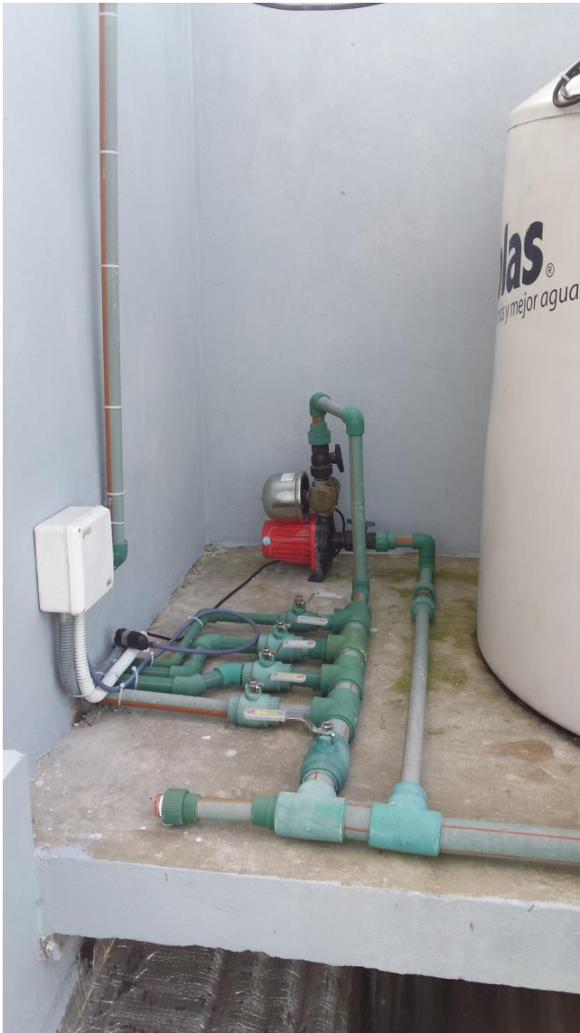
Presurizadora de Agua.
